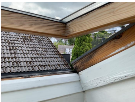
Slitasje, samt begynnende råteskader i karm
